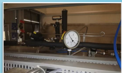
Épreuve hydraulique de requalification périodique
