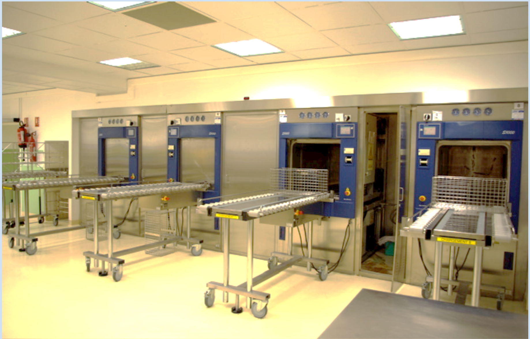
Exemple de batterie d'autoclaves à vapeur d'eau
